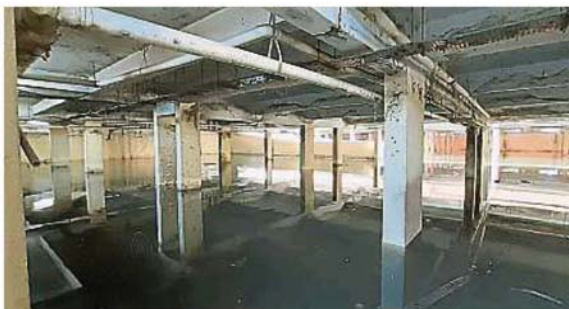
除了日前大雨造成排水受阻，停车场的一些水管也漏水。
