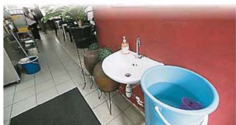
餐館業者在洗手台旁放置一個大水桶，方便顧客洗手。
