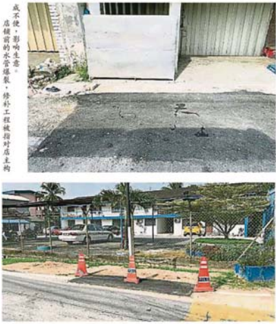
左：水管爆裂，影响生意。右：工程被指时断时续，导致水管爆裂。
